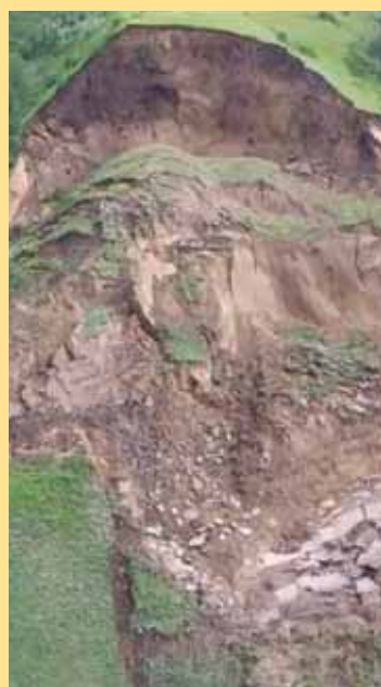
رانش زمین بر اثر تخریب پوشش گیاهی
