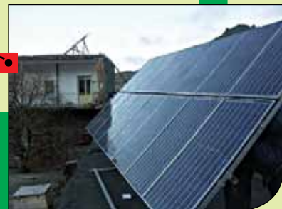
استفاده از سیستم فتوولتائیک برای برق روستاها (منبع: سایت انرژی‌های نو - سانا)
